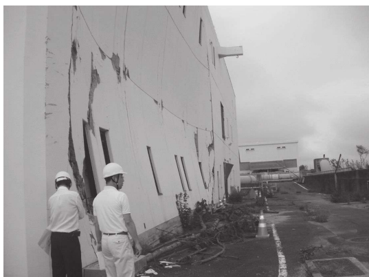
写真2.4 津波で壁面が湾曲した処理施設
