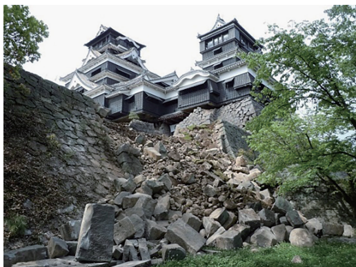
写真2.12 地震により崩壊した熊本城
