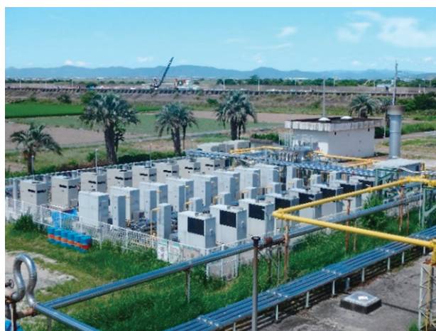
写真-3 消化ガス発電設備
