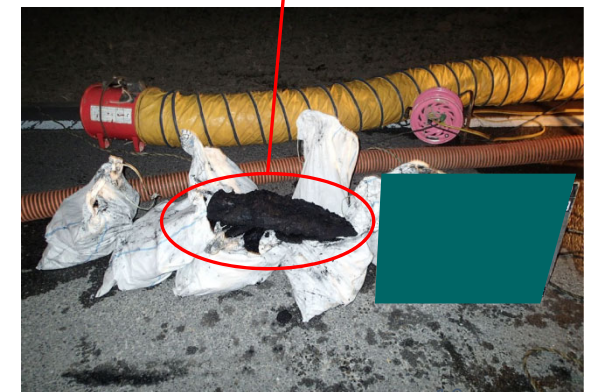
ピット内堆積物(今回清掃時)
