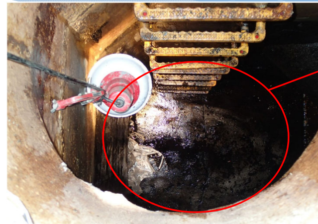
汚水溜り状況
