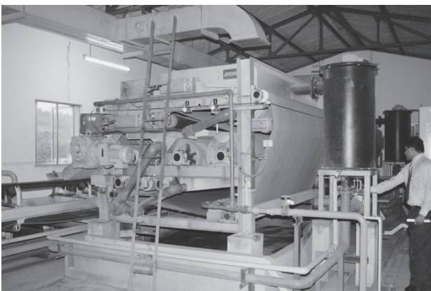
写真-4 汚泥脱水機（引き抜きなし・なんと未使用）
