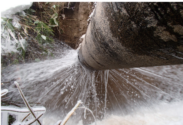
写真-2 平成25年導水管漏水状況
