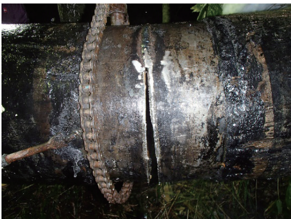
写真-3 溶接部破断状況
