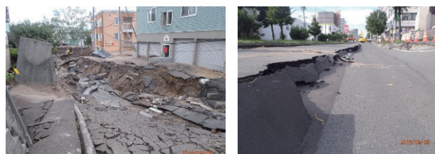
写真-2 胆振東部地震による管路の被災状況
