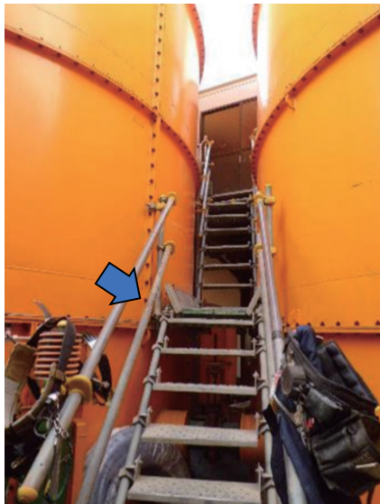
写真-1 鋼製階段が設置できず仮設足場になった
