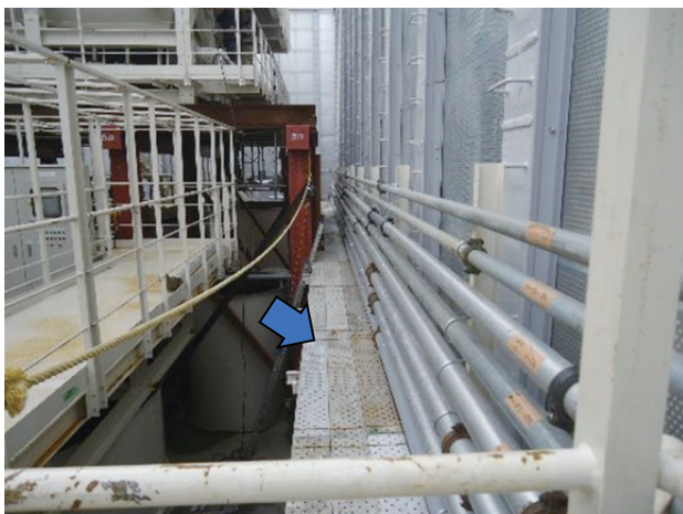
写真-2 鋼製歩廊が設置できず仮設足場になった
