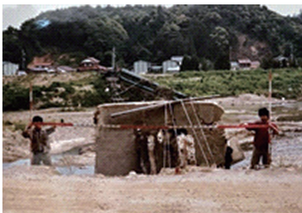
写真-1 災害の状況（橋台が転倒）
