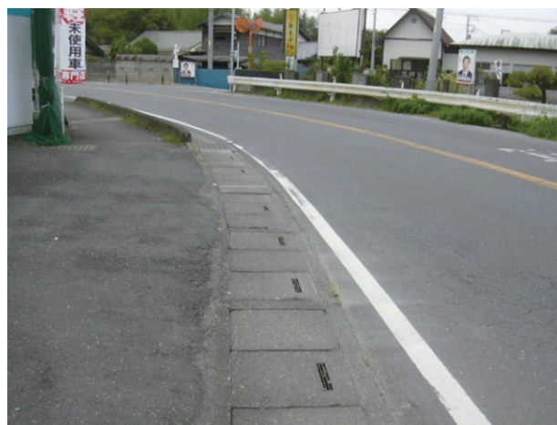
写真－1 現場写真（県道のカーブ地点）
