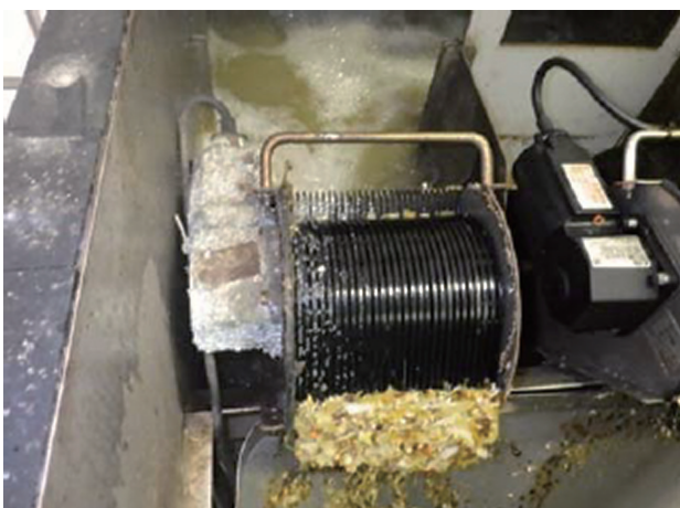
写真－3 処理施設内の自動微細目スクリーン
