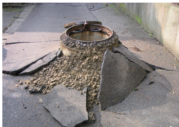
写真－1 人孔浮き上がり状況
