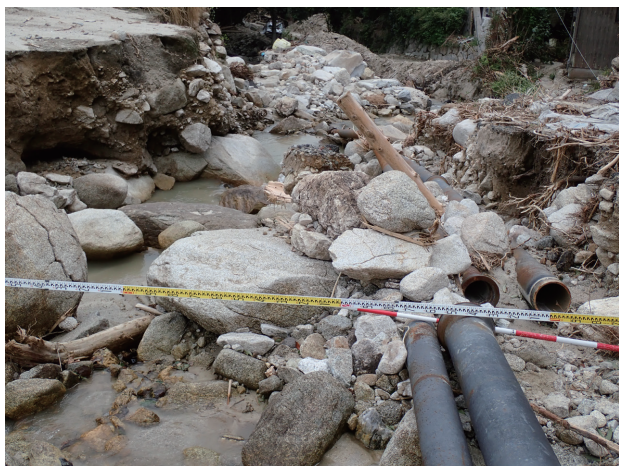
写真-2 被災写真
