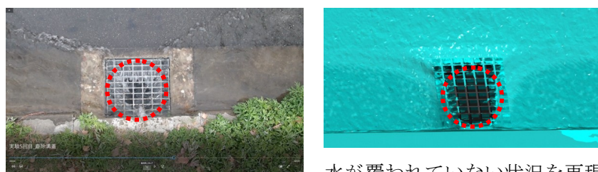
水が覆われていない状況を再現
