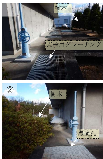
図 1 竣工図書と現場の不一致状況
