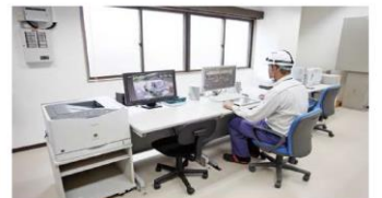
中央監視制御室
