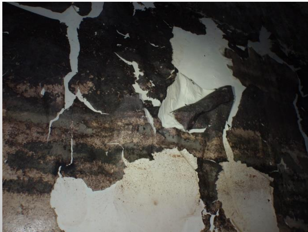
気相部塗膜の剥離 —水抜き点検時の乾燥により、範囲拡大—
