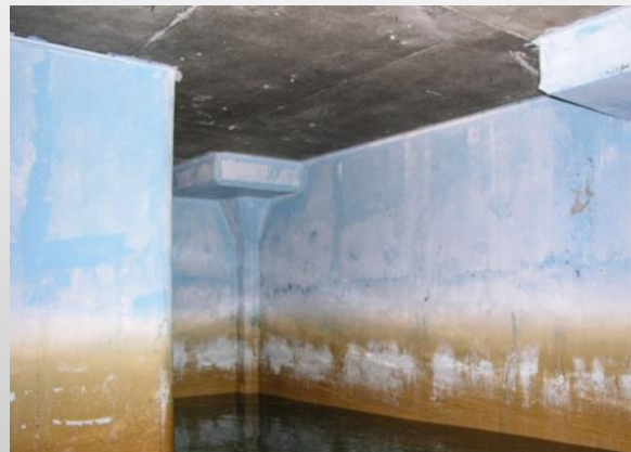
配水池 気相・水中部 有機質系被覆の白化
