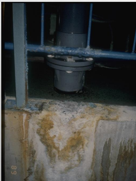
脱臭機のパイプからの漏水による劣化
