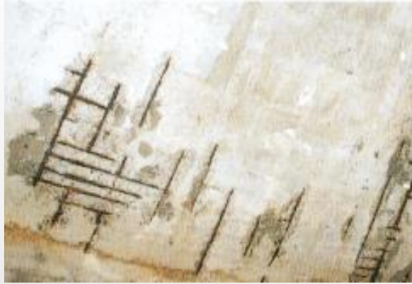
配水池 気相部 鉄筋腐食
