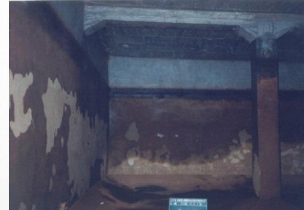
配水池 水中部 モルタル防水表面剥落
