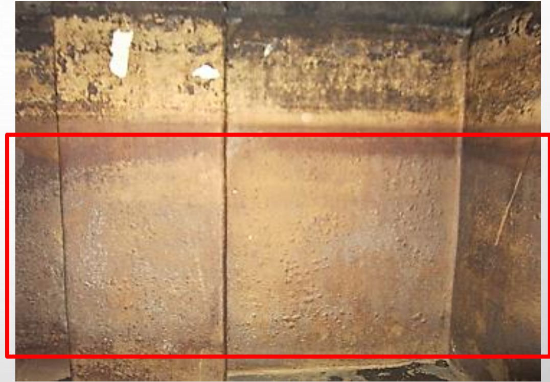
防食被覆層の膨れ
