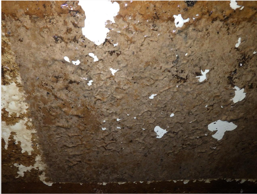
防食被覆層のしわ
