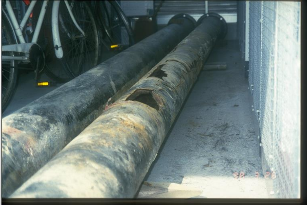
鋳鉄管の破損事例
