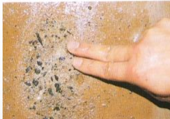
配水池 水中部 表面脆弱化
