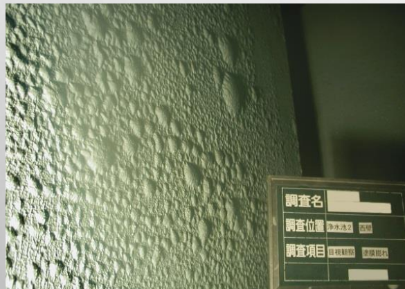
浄水池 水中部 有機質系被覆のフケレ
