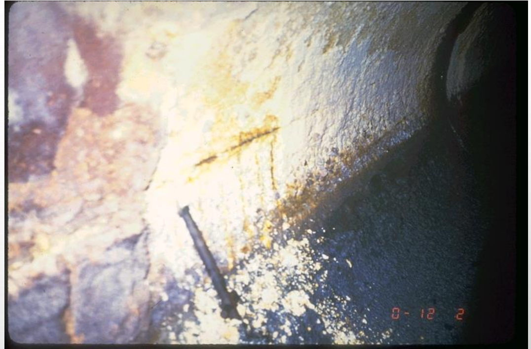
コンクリート管の破損事例
