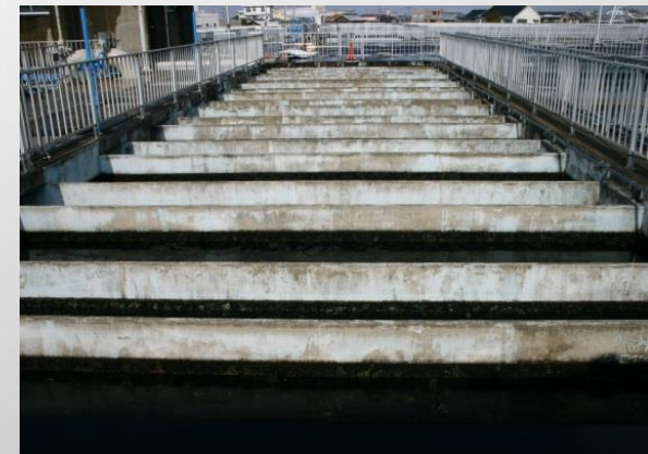
流出水路 屋外 有機質系被覆の被覆厚減少、消失
