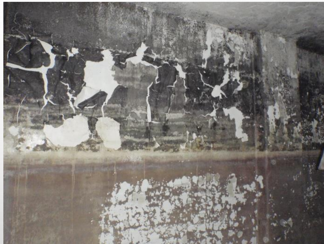
液相部塗膜のふくれおよび剥離
